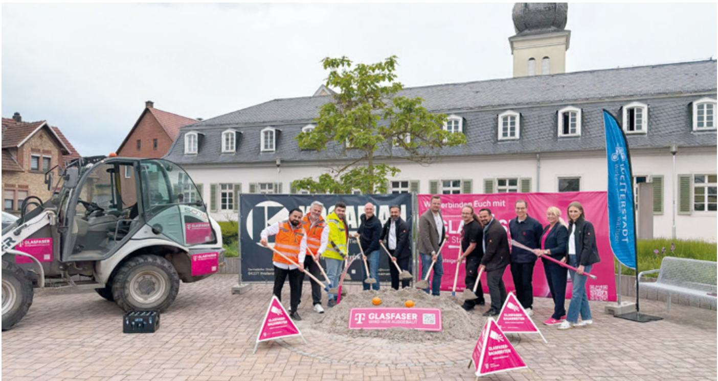
Bürgermeister Niklas Gehnich (Mitte) mit Vertretern der Stadtverwaltung, der Telekom und der ausführenden Baufirma beim symbolischen Spatenstich.
